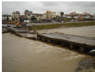
شکل (۱) سیلابی شدن رودخانه چشمه کیله و تخریب پل جانبازان (مهر ۱۳۹۴)
